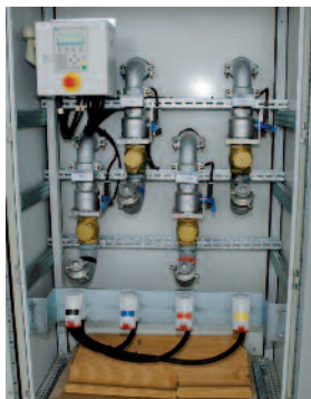
Einspeisung für Großtanks.
